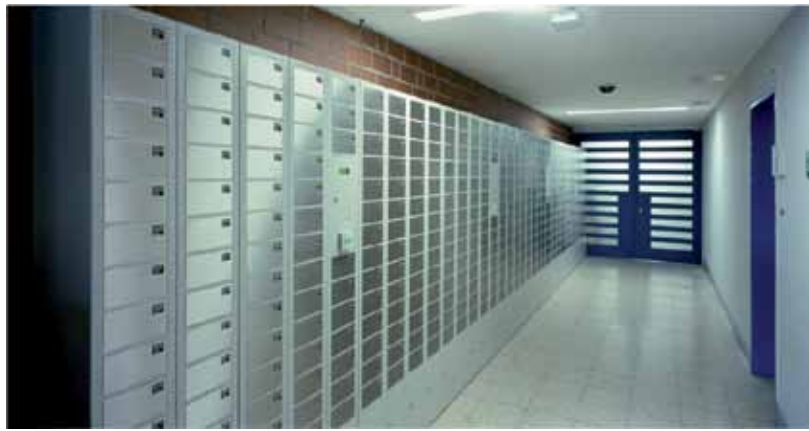
Rys. 5. System Depot Module we więzieniu do przechowywania środków przymusu bezpośredniego
